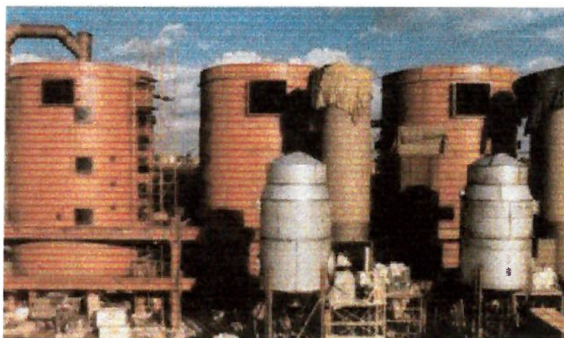
Figura 1 - Utilização de diversos fornos industriais.
